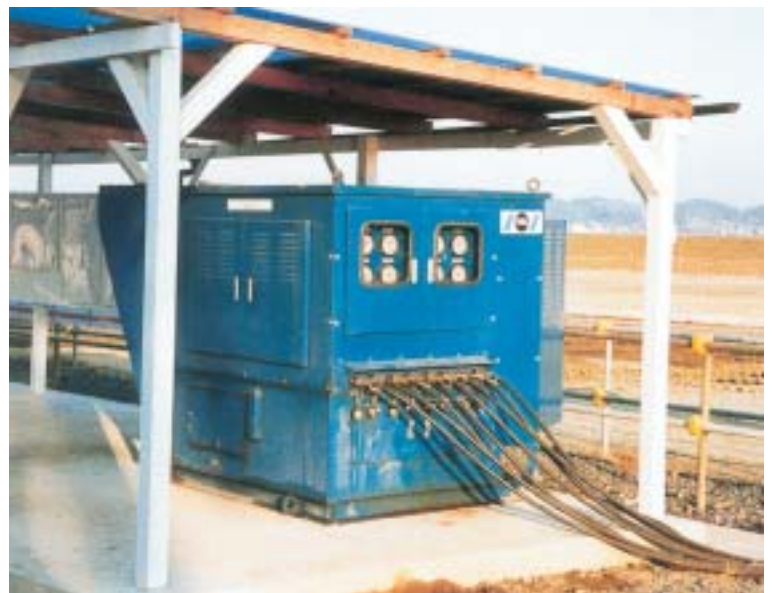
自動制御装置
